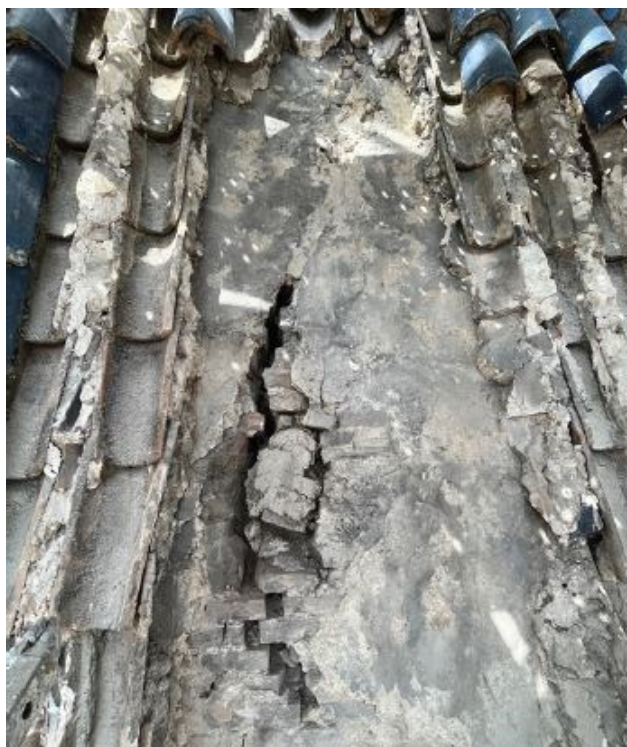
Grieta profunda en la cúpula.
