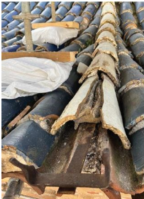
Rotura de tejas.
